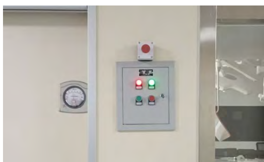
控制室内急停按钮
