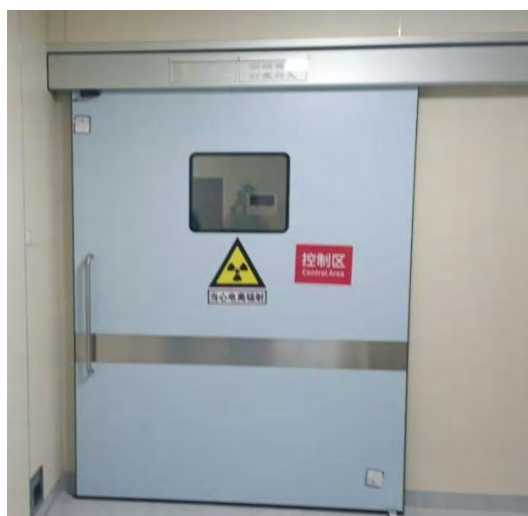
患者入口防护门外电离辐射标志、警示灯、分区标志和脚踢式门控开关
