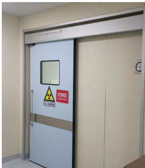
控制室入口处分区标志
