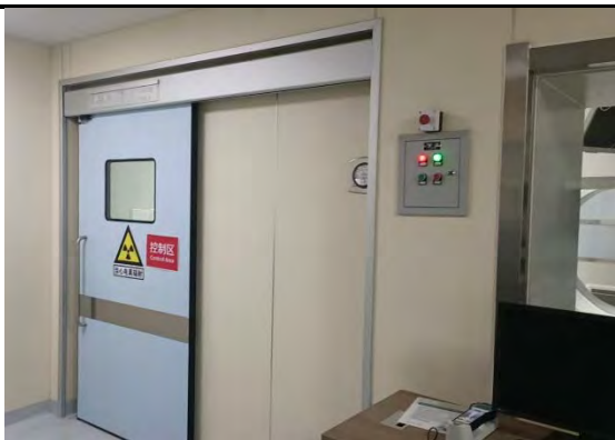
控制室防护门外电离辐射标志、工作指示灯、分区标志
